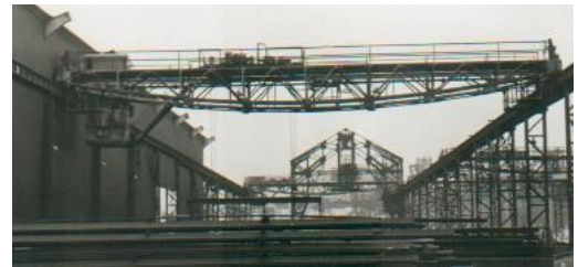
天井走行クレーン
